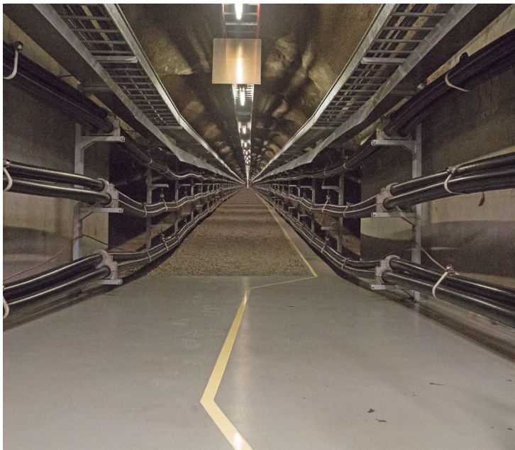
Ljósmynd 69: Fljótsdalsstöð, strengjagöng.
